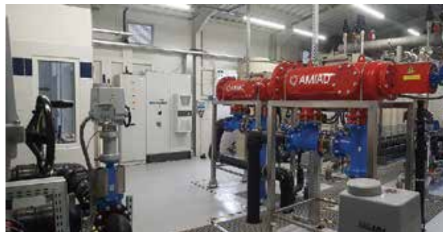
Celkový pohľad na úpravňu, v popredí automatické samočistiace filtre SAF6000
